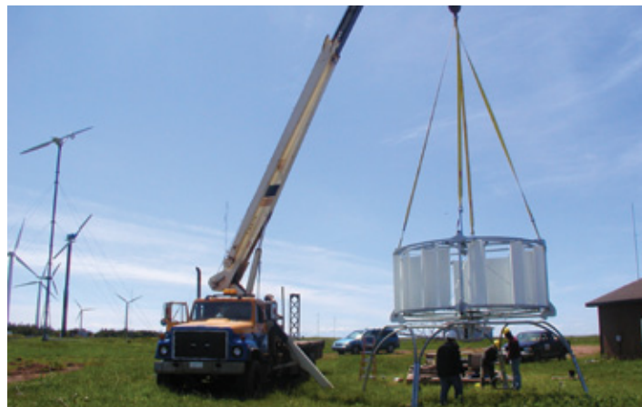
Éolienne à axe vertical de 5kW de Sugan Research Inc.
